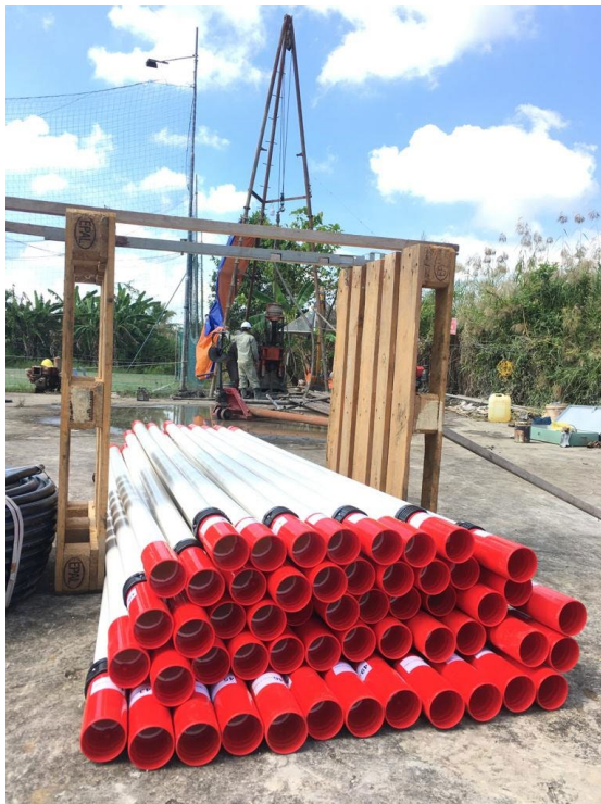
Aufbau des Landsenkungsobservatorium in Ca Mau (Bild: V. H. Long)
